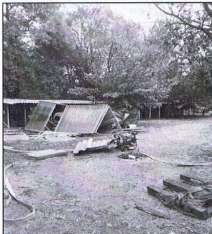
Les toitures des boxes ont été arrachées.
